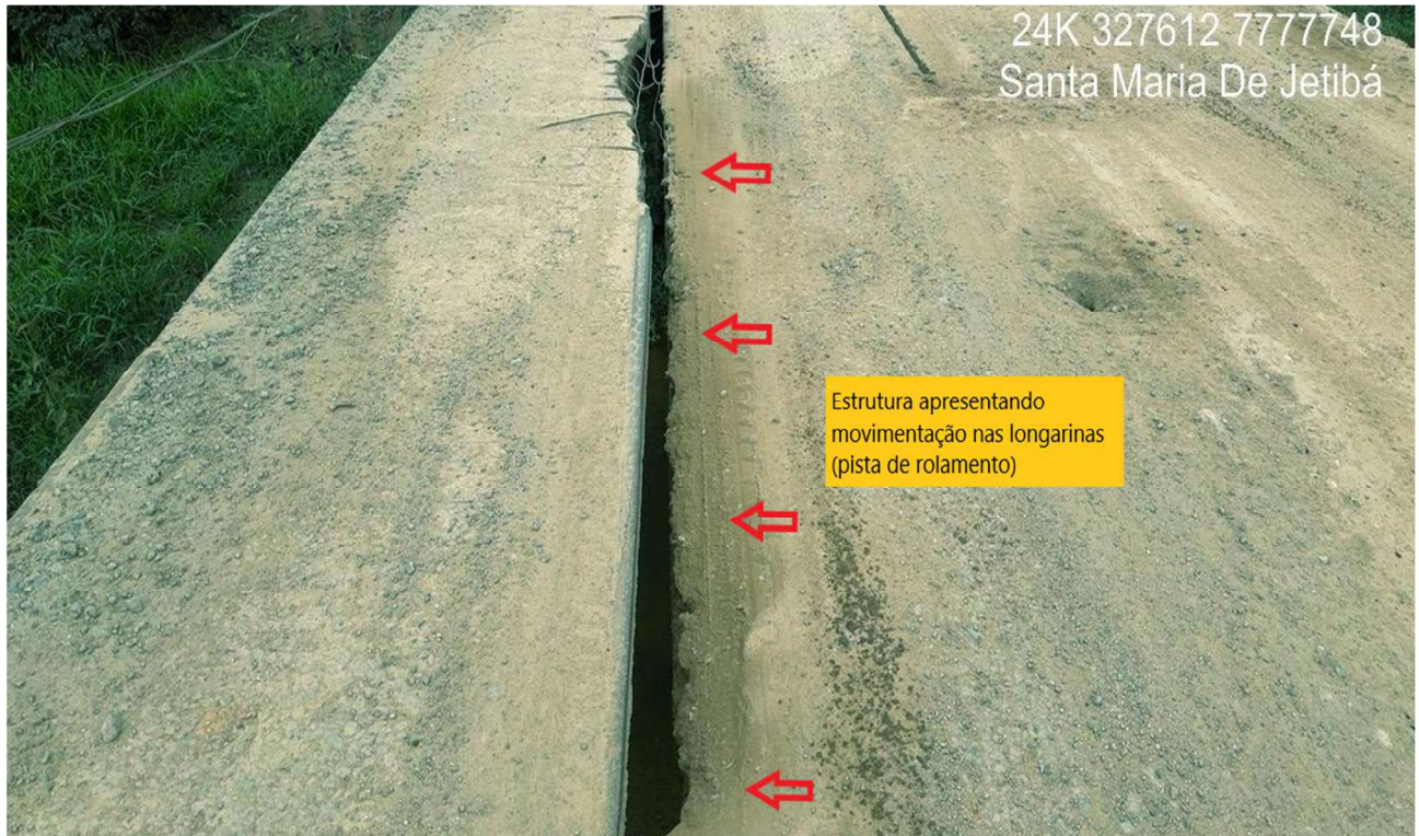
Foto 12 – Vista superior da superestrutura – Pista de rolamento sobre as vigas pré-moldadas modelo “pi”, apresentando desgaste e afastamento em vários pontos do tabuleiro.
