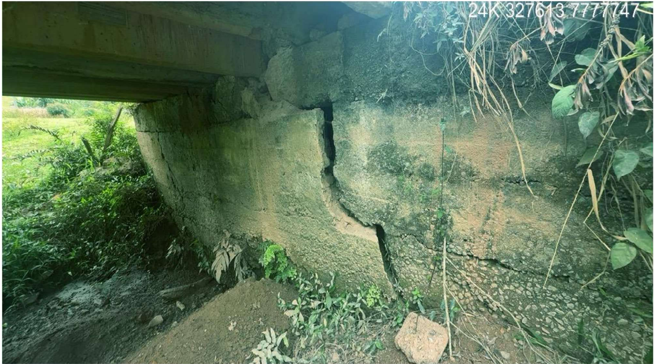
Foto 08 – Vista Mesoestrutura da Ponte – Apresentando trincas graves, armaduras expostas e oxidadas além de concreto deteriorado e deslocando. Estrutura apresentando problemas críticos.
