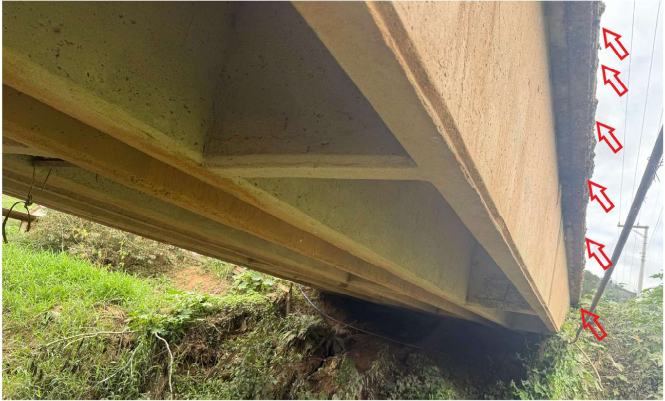
Foto 04 – Vista lateral da Ponte – apresentando marcas das cheias e infiltrações devido à falta de pingadeiras.
