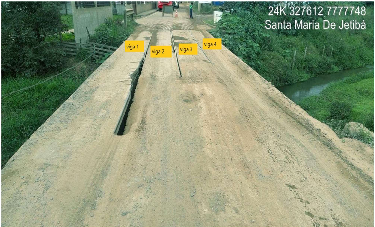
Foto 11 – Vista superior da superestrutura – Pista de rolamento sobre as vigas pré-moldadas modelo “pi”, apresentando desgaste e afastamento em vários pontos do tabuleiro.
