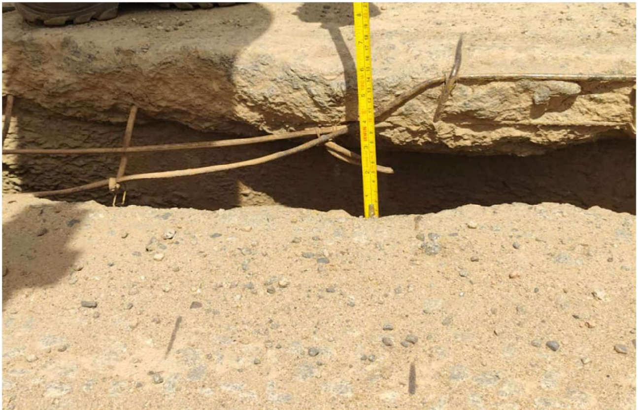
Foto 15 – Vista superior da superestrutura – Pista de rolamento sobre as vigas pré-moldadas modelo “pi”, apresentando desgaste e afastamento em vários pontos do tabuleiro. A estrutura apresenta estado crítico e de alto risco.
