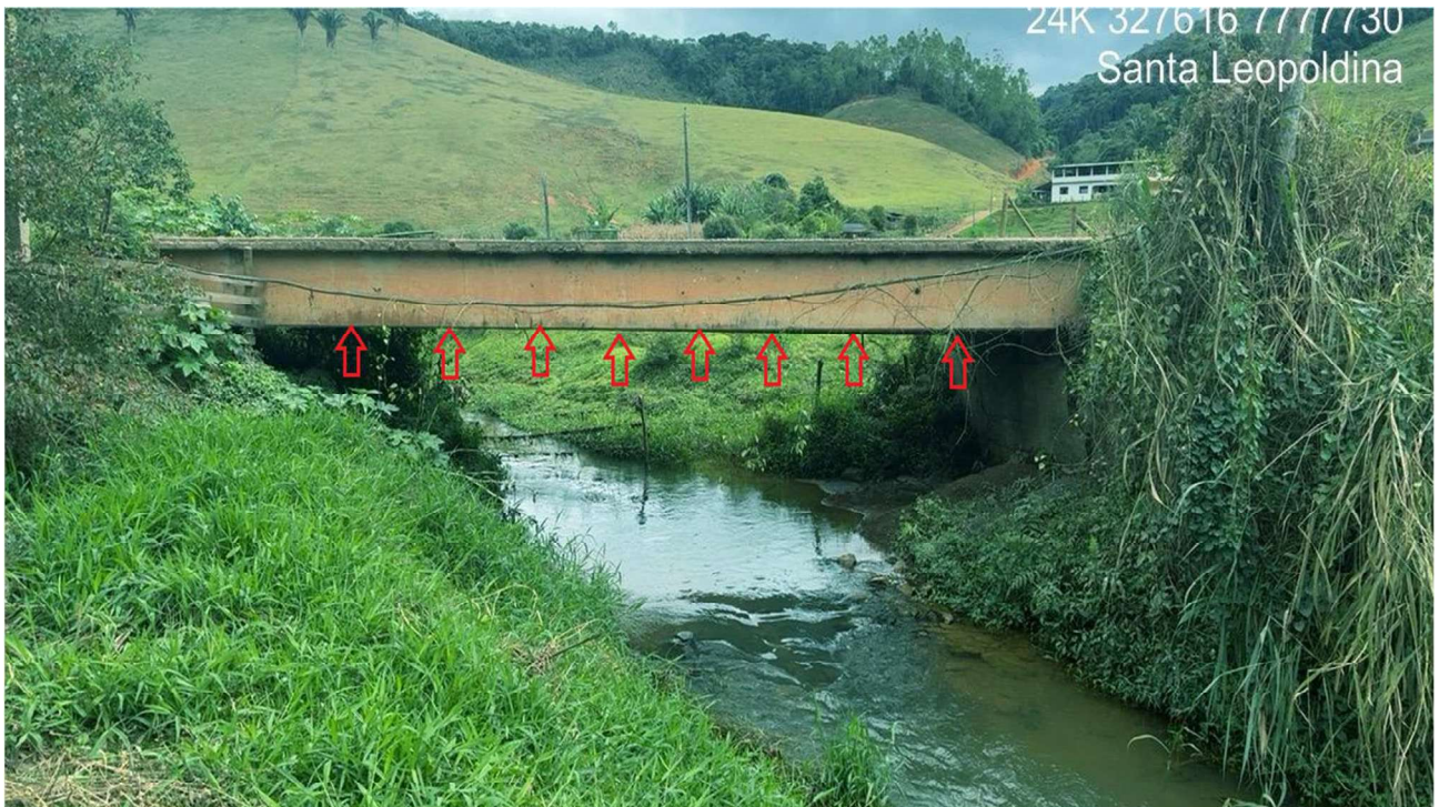
Foto 03 – Vista lateral da Ponte – apresentando marcas das cheias e infiltrações devido a falta de pingadeiras.
