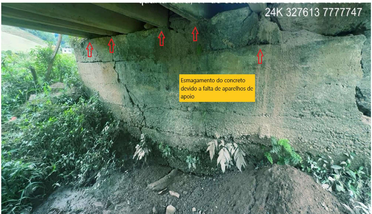
Foto 09 – Vista Mesoestrutura da Ponte – Apresentando marcas das cheias além do concreto deteriorado e deslocando. Nos apoios das vigas longarinas está ocorrendo esmagamento do concreto devido à falta de aparelhos de apoio.
