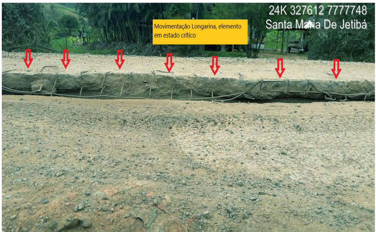
Foto 13 – Vista superior da superestrutura – Pista de rolamento sobre as vigas pré-moldadas modelo “pi”, apresentando desgaste e afastamento em vários pontos do tabuleiro. A estrutura apresenta estado crítico e de alto risco.
