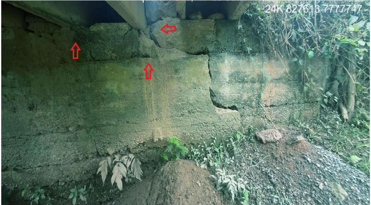
Foto 10 – Vista Mesoestrutura da Ponte – Apresentando marcas das cheias além do concreto deteriorado e deslocando. Nos apoios das vigas longarinas está ocorrendo esmagamento do concreto devido à falta de aparelhos de apoio.
