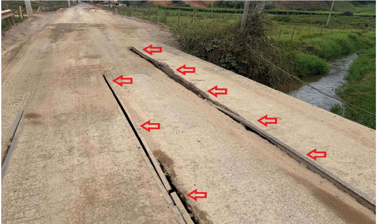
Foto 14 – Vista superior da superestrutura – Pista de rolamento sobre as vigas pré-moldadas modelo “pi”, apresentando desgaste e afastamento em vários pontos do tabuleiro. A estrutura apresenta estado crítico e de alto risco.
