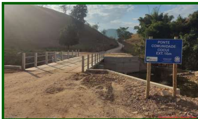
Ponte executada na localidade de Cocuí - no município de Cachoeiro de Itapemirim/ES
