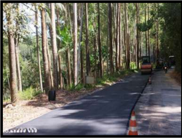
Reabilitação de rodovia na localidade de Ribeirão dos Lagos - no município de Marechal Floriano/ES
