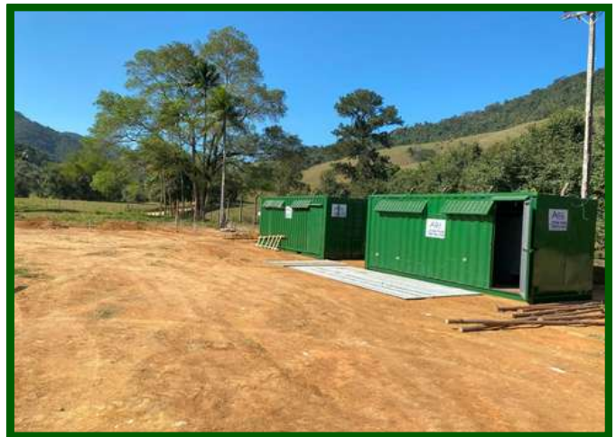
Canteiro de obras da obra de pavimentação do trecho BR-101 - Pau D'óleo- no município de Guarapari/ES
