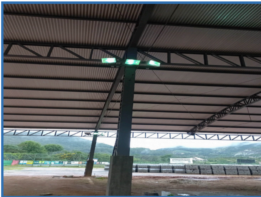
Figura 79: Instalações elétricas e combate a incêndio no Morangão, em Domingos Martins/ES. Fonte: SEAG.
